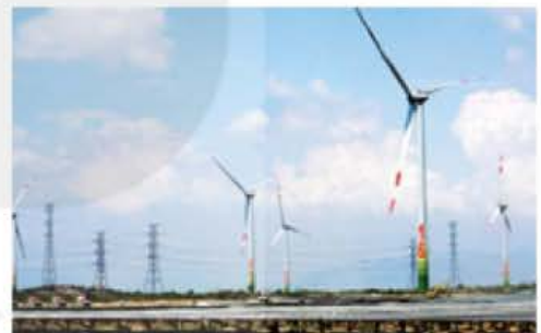
Hình 8.5. Nhà máy điện gió Trung Nam, Khánh Hoà
