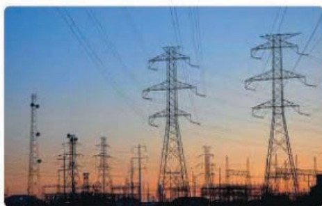
Đường dây điện cao thế
